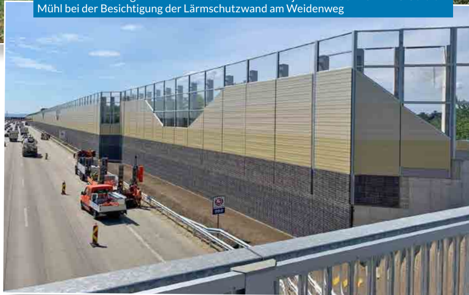
Ing. Josef Podek und Ing. Christoph Simanko vom Bauamt, Bgm. Herbert Janschka, Lärmsachverständiger DI Werner Kaufmann und Projektleiter der ASFINAG Gerald Mühl bei der Besichtigung der Lärmschutzwand am Weidenweg
