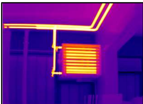
ständige Durchströmung auch wenn der Heizlüfter nicht in Betrieb ist --> Energiebedarf
