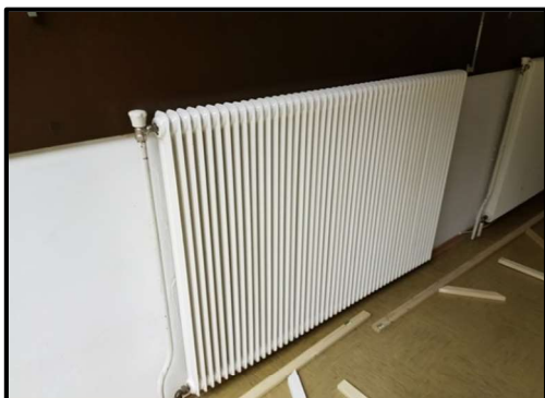
Es sind noch keine Thermostatköpfe montiert
