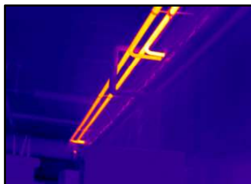
Wärmeverlust durch ungedämmte Rohre in den Hallen
